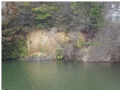
ため池周囲 土砂崩壊
