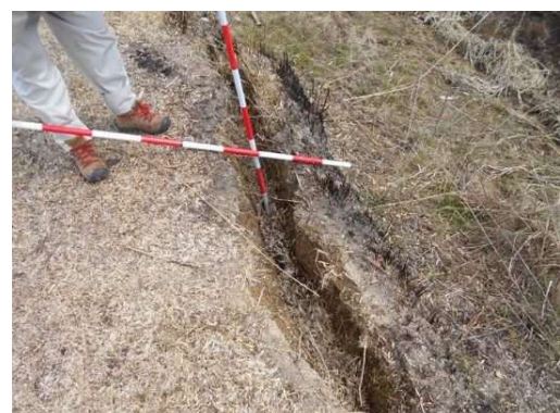
堤頂 ひび割れ
