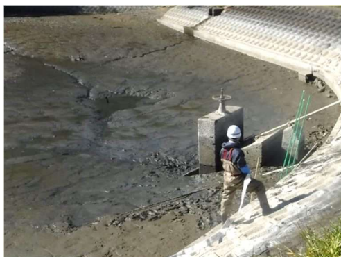
泥土堆積状況(かいぼり実施前)
