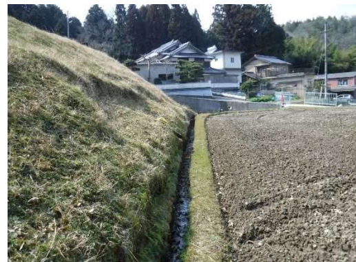
後法 はらみだし及び陥没
