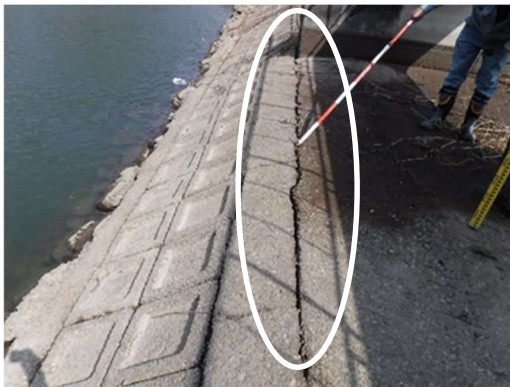
洪水吐流入部 ひび割れ
