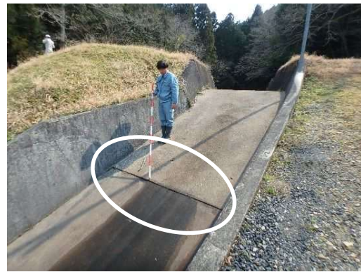
放水路部 漏水
