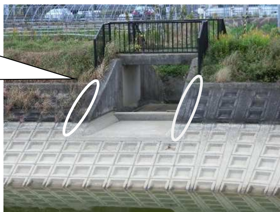
洪水吐(貯水池側より)
