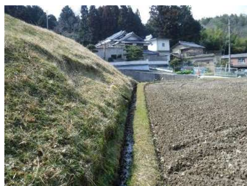
後法 はらみだし及び陥没
