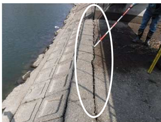
洪水吐流入部 ひび割れ
