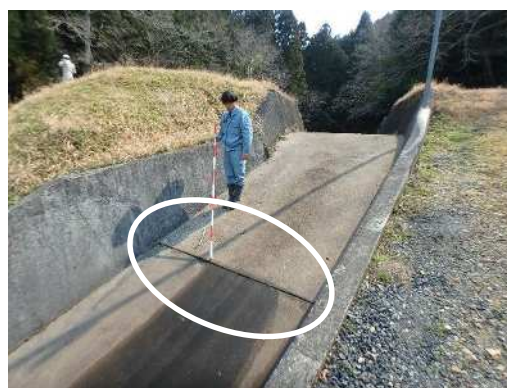
放水路部 漏水
