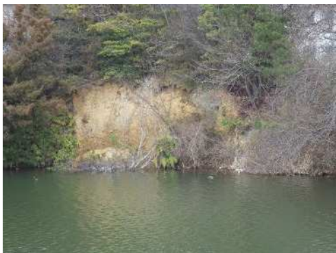
ため池周囲 土砂崩壊
