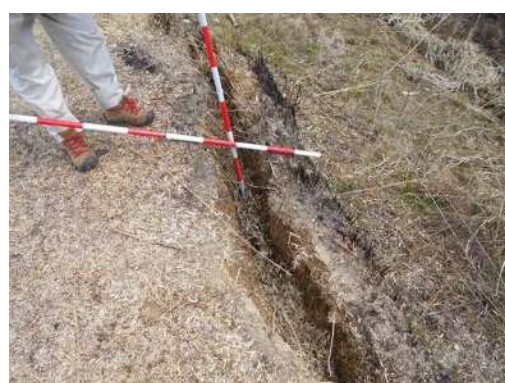
堤頂 ひび割れ
