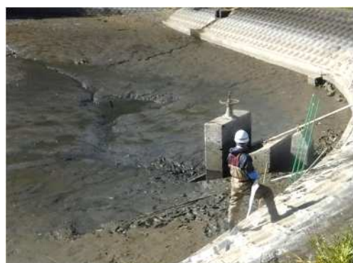
泥土堆積状況(かいぼり実施前)
