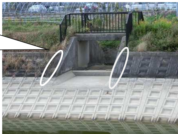
洪水吐(貯水池側より)
