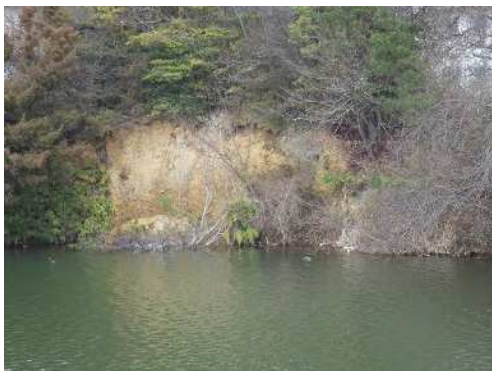
ため池周囲 土砂崩壊
