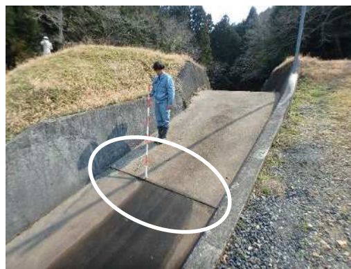
放水路部 漏水
