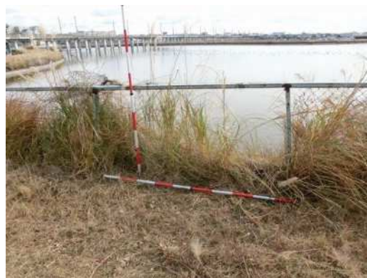
柵の破損 (網が破れていないか確認しましょう)
