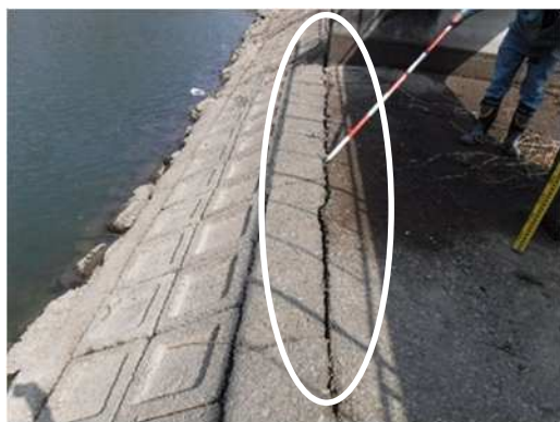
洪水吐流入部 ひび割れ
