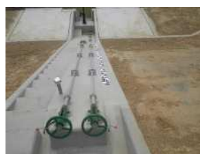
取水施設(斜樋)
