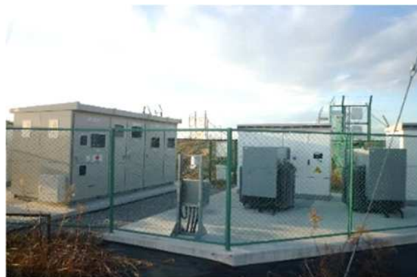
変電設備における侵入防止柵
