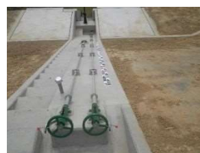
取水施設(斜樋)
