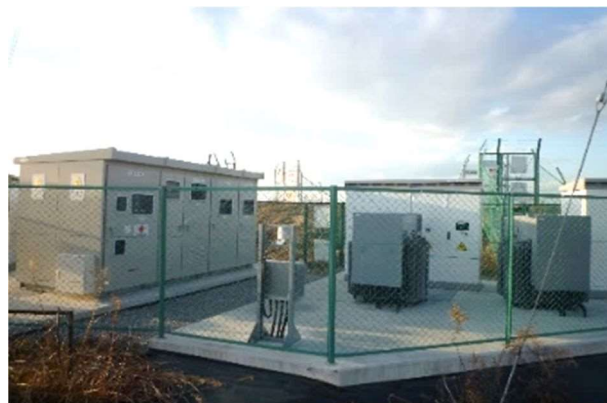
変電設備における侵入防止柵
