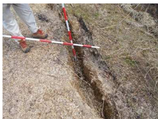
堤頂 ひび割れ
