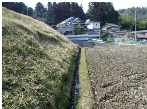
後法 はらみだし及び陥没
