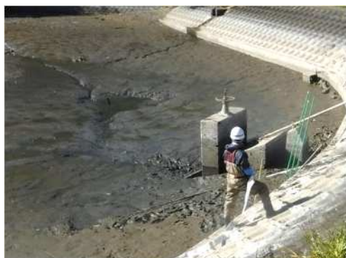
泥土堆積状況(かいぼり実施前)
