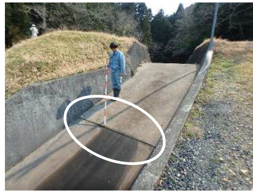
放水路部 漏水
