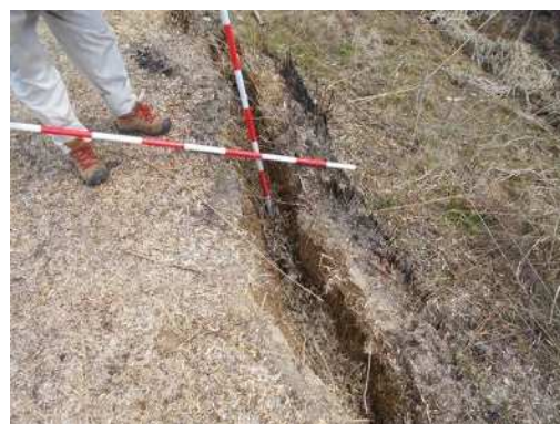
堤頂 ひび割れ
