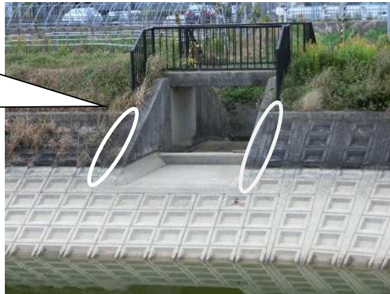
洪水吐(貯水池側より)
