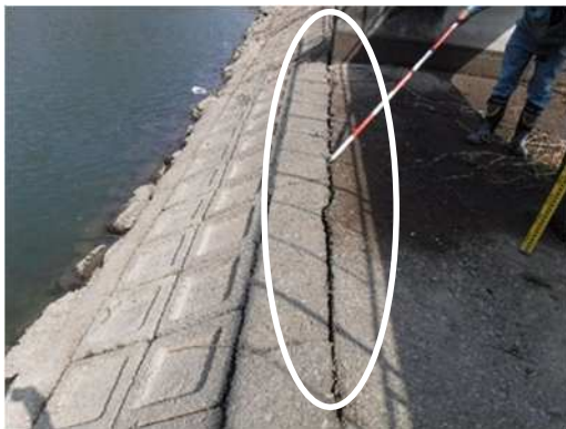
洪水吐流入部 ひび割れ
