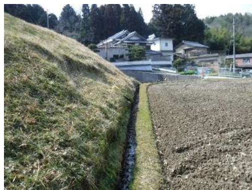
後法 はらみだし及び陥没
