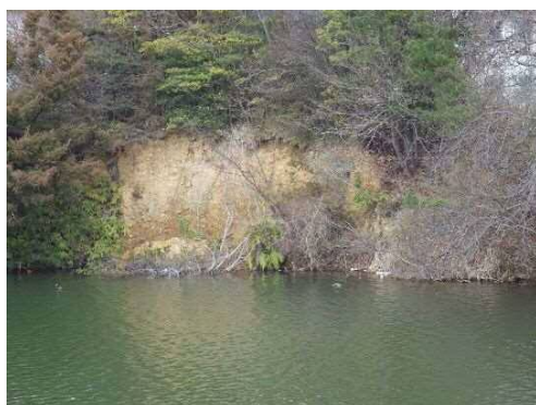
ため池周囲 土砂崩壊
