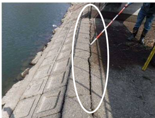
洪水吐流入部 ひび割れ
