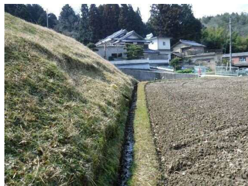
後法 はらみだし及び陥没
