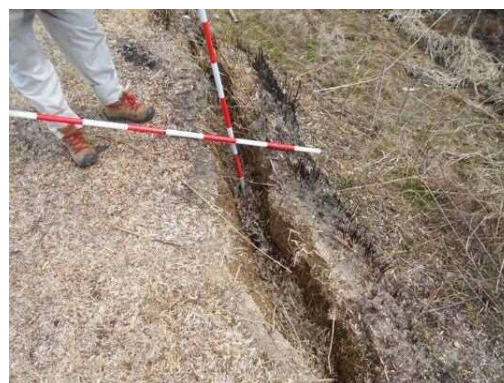
堤頂 ひび割れ
