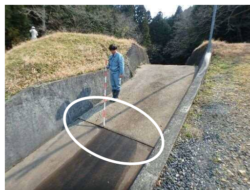
放水路部 漏水
