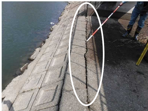
洪水吐流入部 ひび割れ
