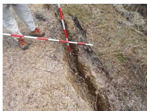
堤頂 ひび割れ
