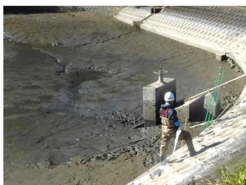
泥土堆積状況(かいぼり実施前)
