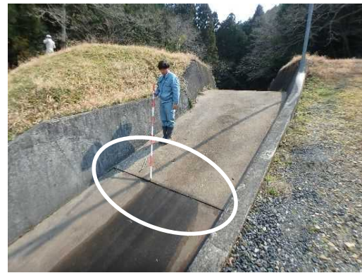
放水路部 漏水
