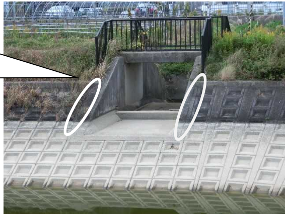
洪水吐(貯水池側より)
