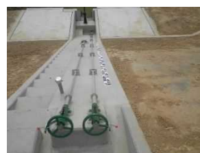
取水施設(斜樋)
