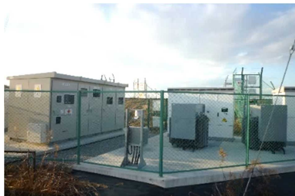
変電設備における侵入防止柵
