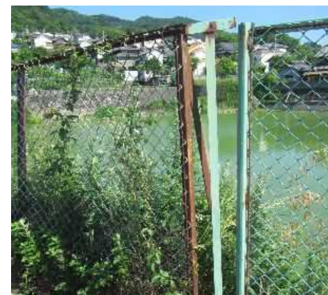
安全柵の破損状況
