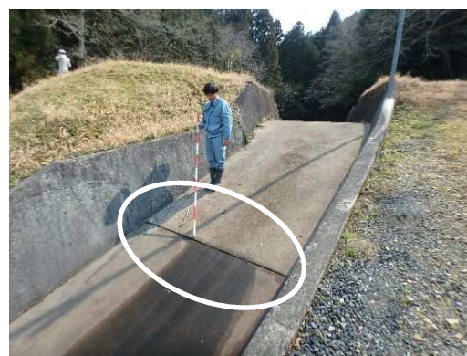
放水路部 漏水
