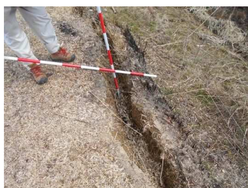
堤頂 ひび割れ
