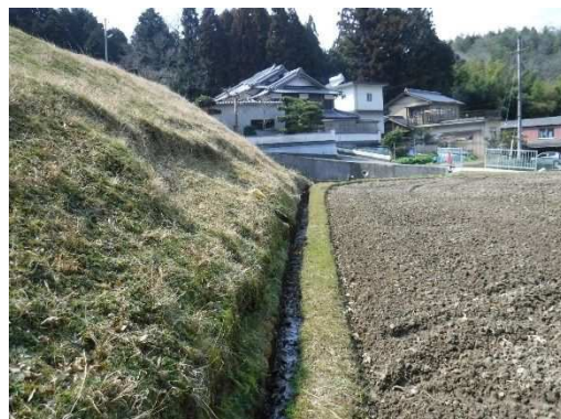
後法 はらみだし及び陥没
