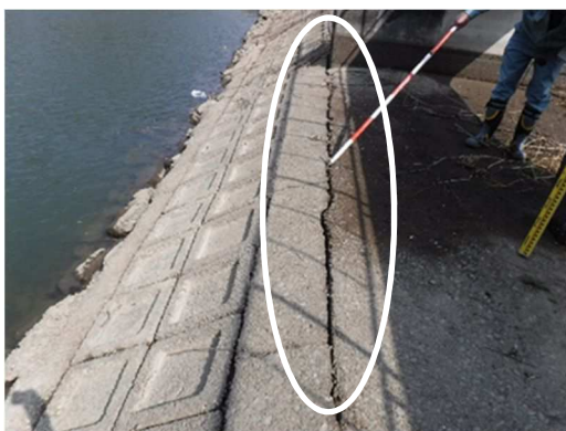
洪水吐流入部 ひび割れ
