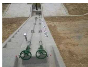
取水施設(斜樋)
