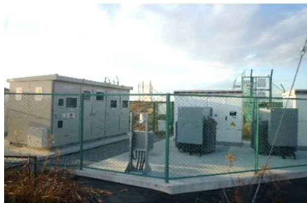
変電設備における侵入防止柵
