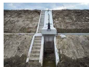
取水施設(底樋)
